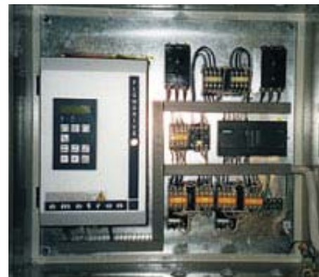
Рис. 2. Преобразователь FDU на 5,5 кВт в электрошкафу
