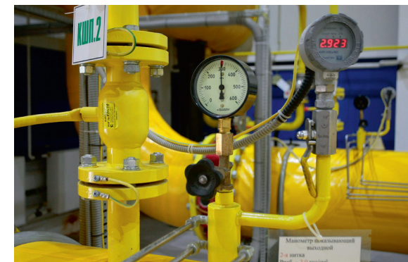
Рисунок 2. Шаровые краны «Бивал» и дисковые затворы «Гранвэл», установленные в ГПП «Черкизовская ГС», г. Москва
